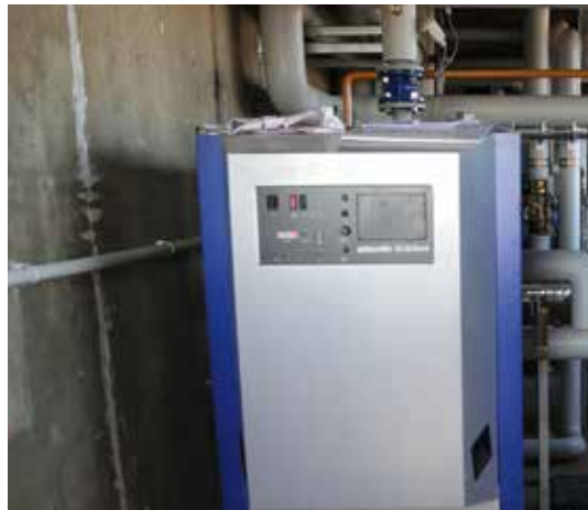
Chaudière rue Pierre Curie
